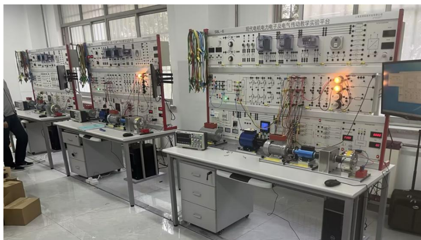
图 3 电机电力电子及电气传动教学实验室
